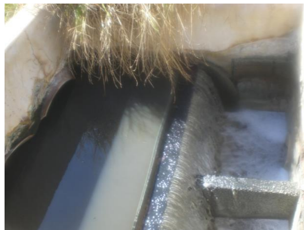
Figura 4. Caixa de distribuição de fluxo na entrada da primeira lagoa facultativa.
