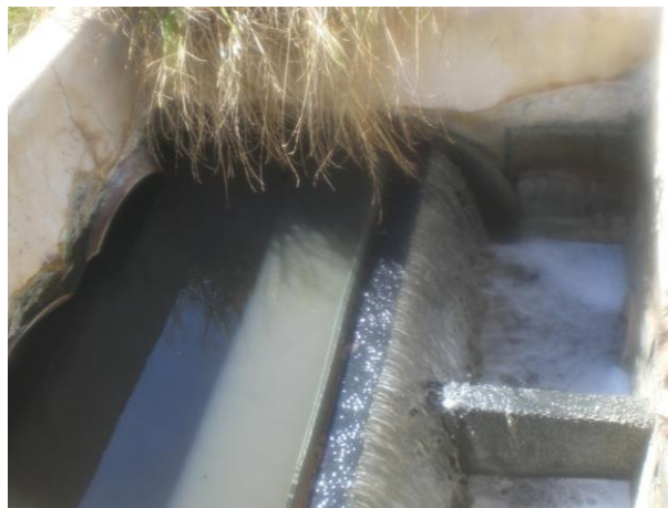
Figura 4. Caixa de distribuição de fluxo na entrada da primeira lagoa facultativa.
